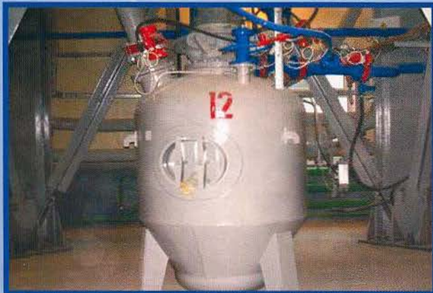
Камерные насосы в сборе с подающими цементопроводами и трубопроводами сжатого воздуха (голубой цвет)
