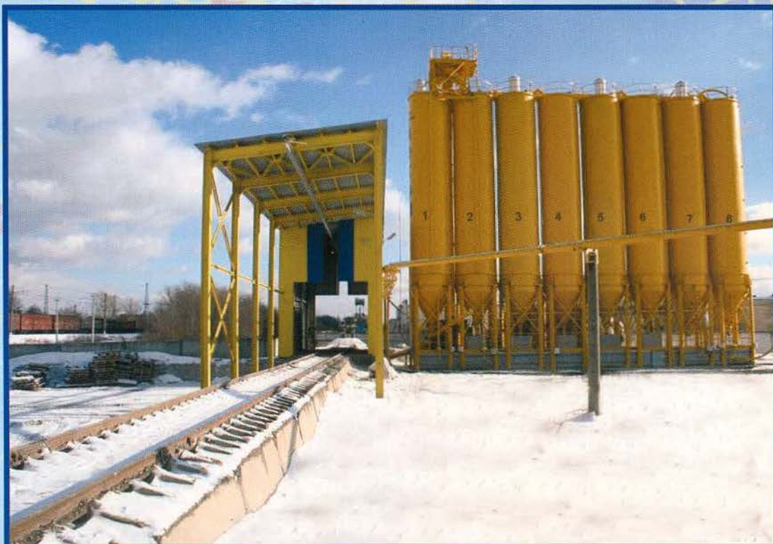
Блок силосов с приемным устройством
