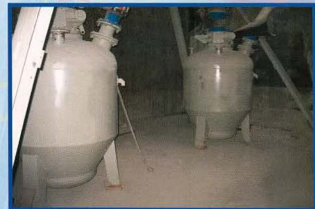
Камерные насосы приемного устройства с собранными подающими цементопроводами
