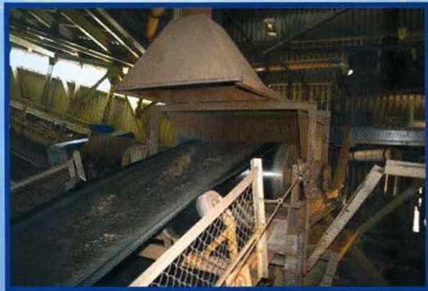
Узел перегрузки заполнителей
